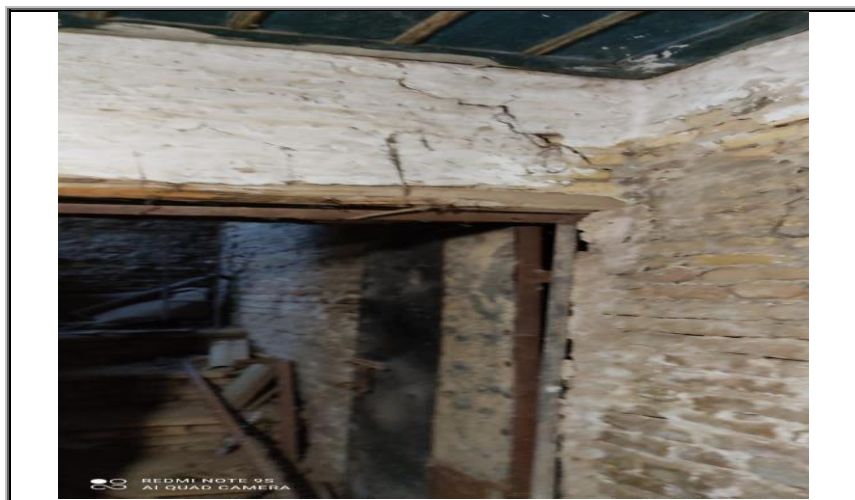
صورة (6) اثر الرطوبة في احد لأبنية القديمة في مربع المدينة لمدينة الناصرية لسنة 2025
