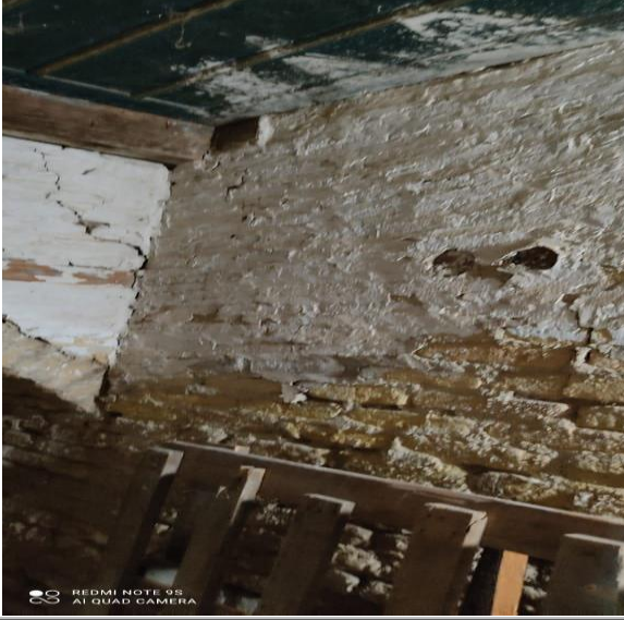
صورة (2) بناء قديم تظهر فيه ترسب الاملاح بسبب عامل الزمن في منطقة السيف لمدينة الناصرية
